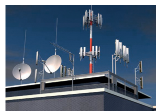
Antenas e mastros
