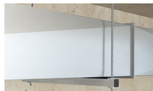
Duto de ventilação em perfil suspenso: FAW
