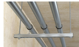
Tubulação em perfil suspenso: FAW
